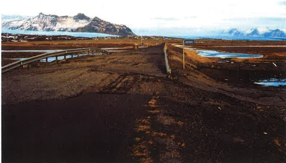
1. mynd: Hringvegurinn við Kvísker hefur ítrekað skemmt í ofsaveðrum þegar hluti slitlagsins flettist af veginum. Hér er horft til norðurs í átt að Fjalls- og Breiðamerkurjökli. Ljósmynd: Sigurður Gunnarsson, Hnappavöllum.
